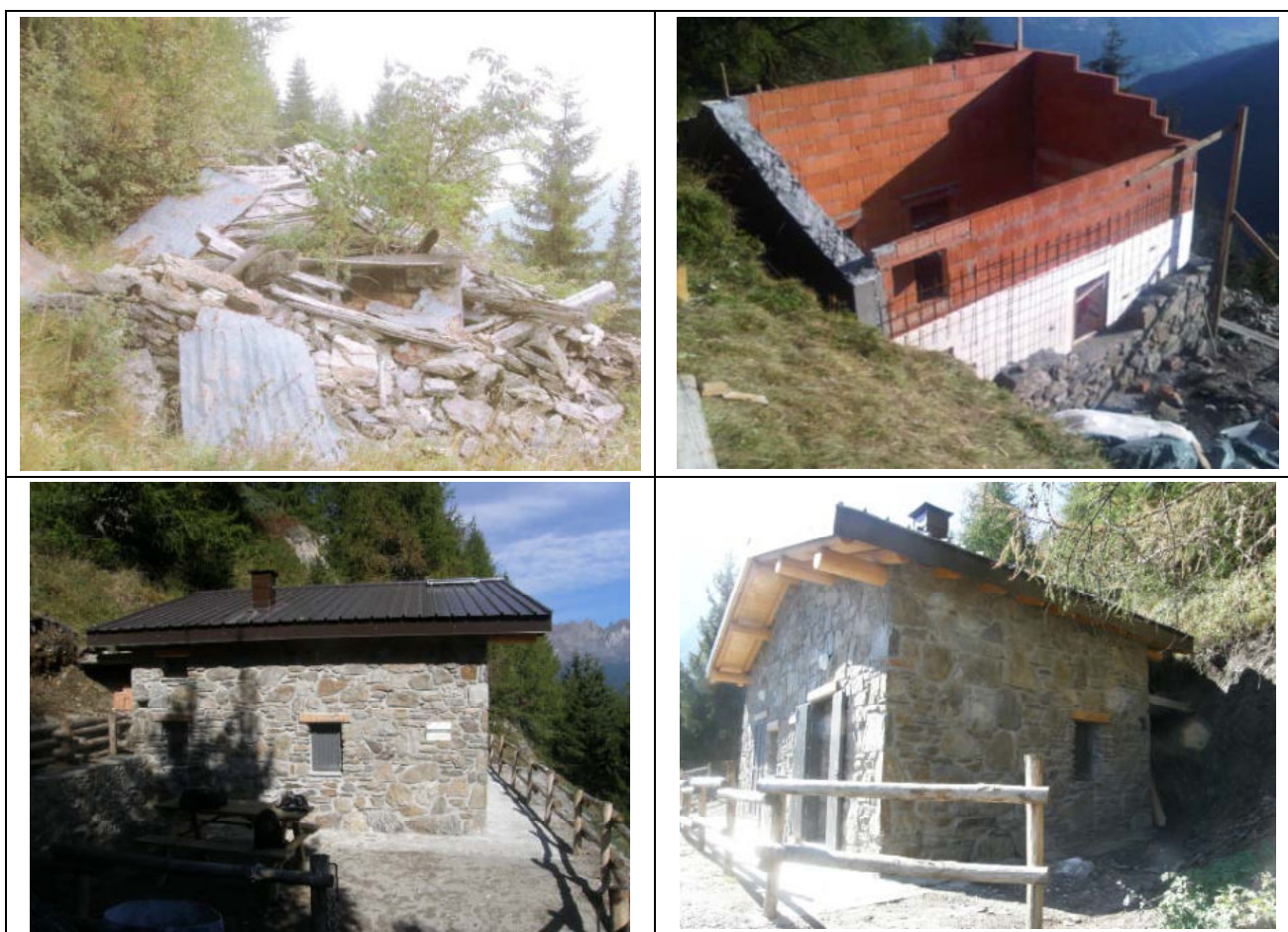
Figura 2.3.4 – Immagini di Malga Laghetto pre-intervento di recupero (in alto a sx), durante l'intervento di recupero (in alto a dx) e a lavori ultimati (in basso).
